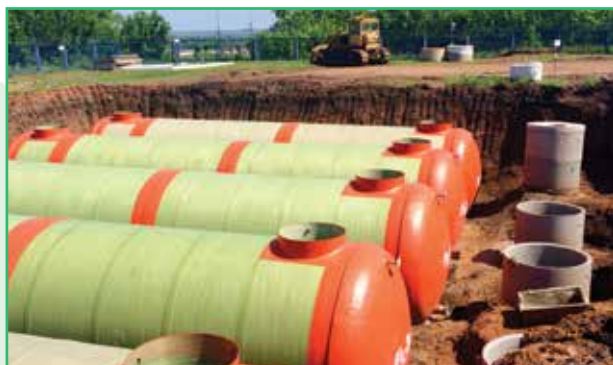
г. Уфа, Автомобильная газонаполнительная компрессорная станция (АГКС)
