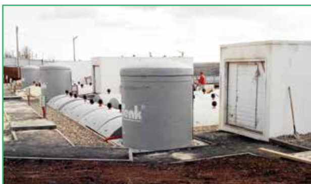
Ростовская область, г. Шахты, городские очистные сооружения
