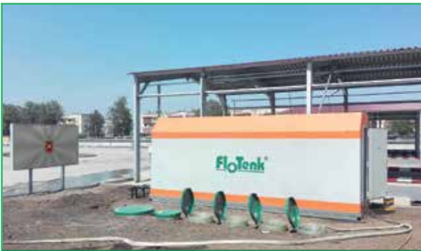
Оборотное водоснабжение автомойки Военной части, Владикавказ
